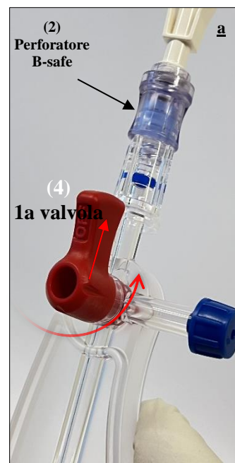
Fig 33 Rotazione della prima valvola in posizione OFF per isolare la sacca di acido.
